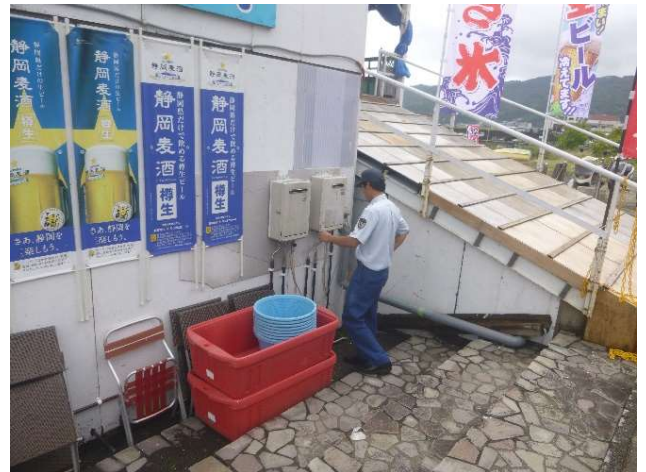
給湯器の設置状況の確認
